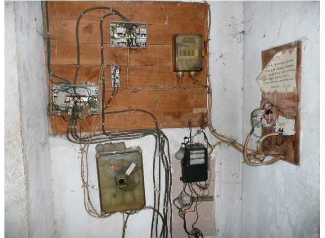
Figure 15a. Panne d'électricité.
